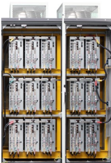
Рис. 3.7 Расположение в шкафу силовых модулей
