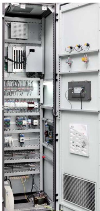
Рис. 3.8 Расположение в шкафу управления
